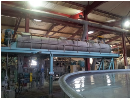
Bestehende Anlage beim Kunden
