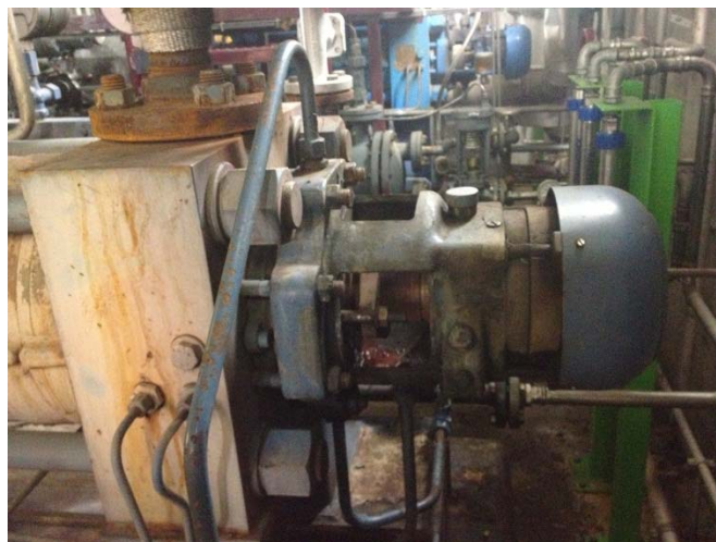
Gehäuseoberfläche zeigt starke Überhitzungserscheinungen
